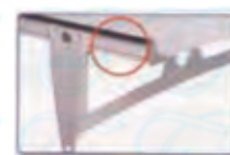
Guarnizione tra muro e pensilina
